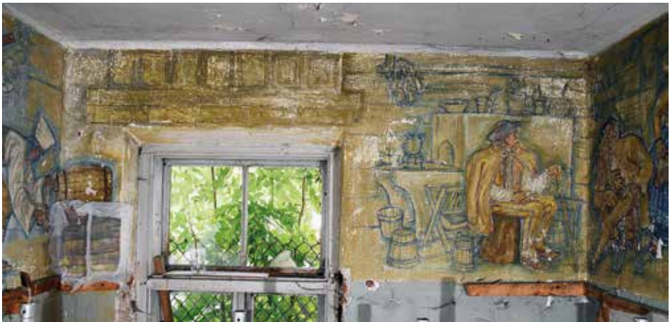
Władysław Trebunia-Tutka, Wesele góralskie , 1971, budynek dawnej Mineralnej Spółdzielni Pracy „Budimet” w Suchem, ściana wschodnia. Stan przed konserwacją. Fot. J. Pietrzyk
