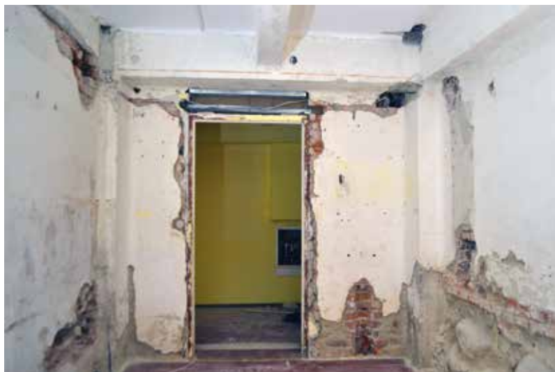
Ściana północna. Stan po usunięciu wtórnych nawarstwień i oczyszczeniu powierzchni, widoczny zakres ubytków wątku ceglanego i wypraw. Przebarwienie powierzchni spowodowane krystalizacją soli.
