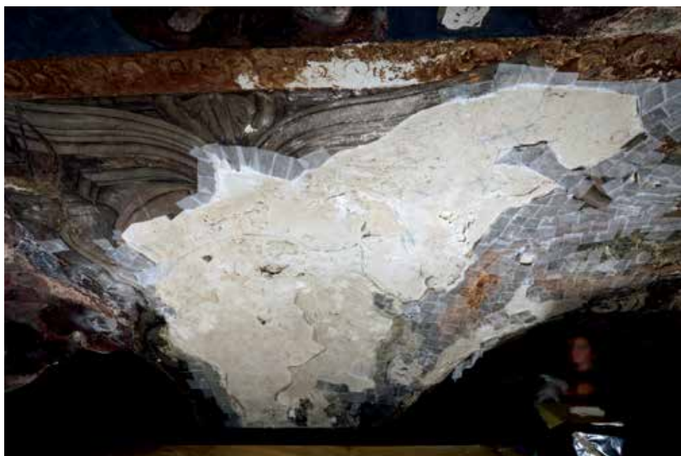
Północna część sklepienia nad prezbiterium. Malowidło w trakcie zabezpieczania bibułką japońską oraz gazą z roztworem Klucelu G. Fot. P. Boliński
