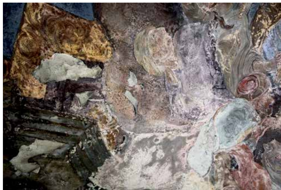
Południowo-zachodnia część prezbiterium przed przystąpieniem do prac konserwatorskich. Widoczne są rozległe wykwity soli pod różnymi postaciami – białe „kalafiori”, żółtawienia, ciemne plamy oraz kropki, a także spękania i odspojenia warstwy malarskiej i tynku. Fot. K. Matusiak
