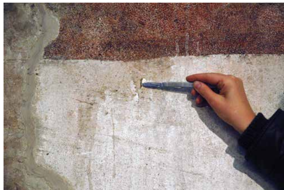
Kraków, kościół Najświętszego Salwatora, prezbiterium, ściana wschodnia. Zacieki z żywicy syntetycznej, zastosowanej w latach 70. XX wieku do utrwalenia malowidła ściennego. Widoczna odspajająca się gruba, przybrudzona błona spoiwa. Fot. D. Białek-Kostecka
