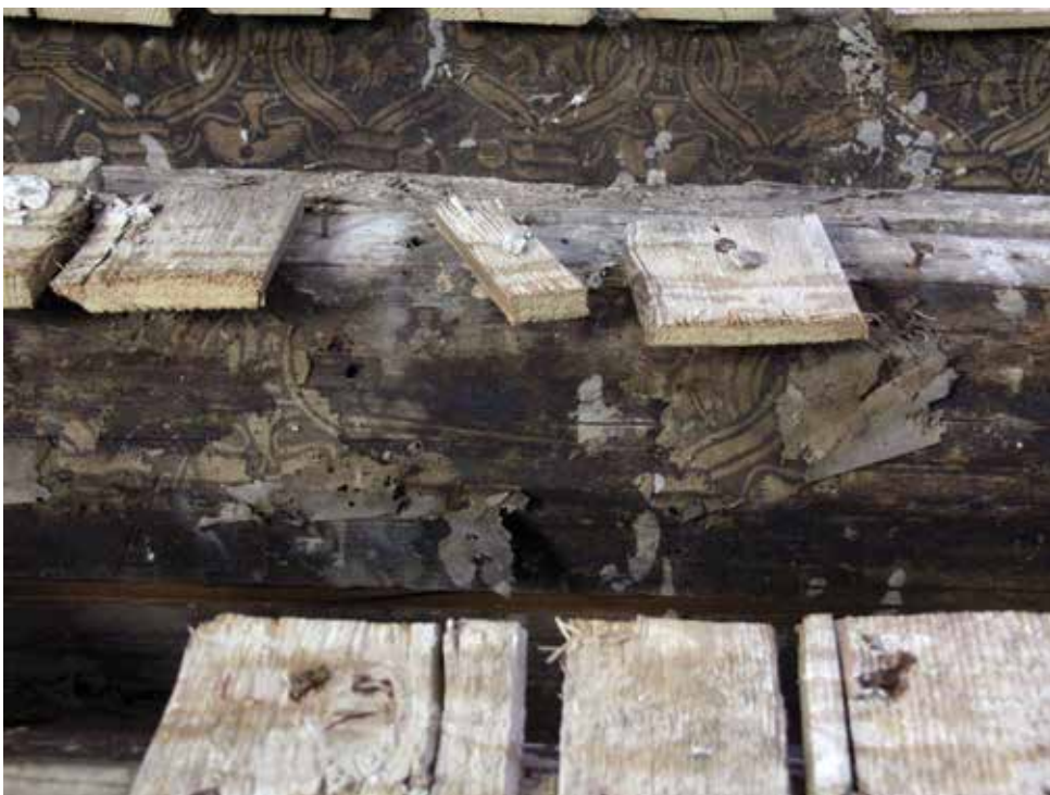
Kraków, klasztor oo. Dominikanów, ul. Dominikańska 1, stan zachowania koltryn przed rozpoczęciem prac konserwatorskich. Fot. S. Strzelczyk
