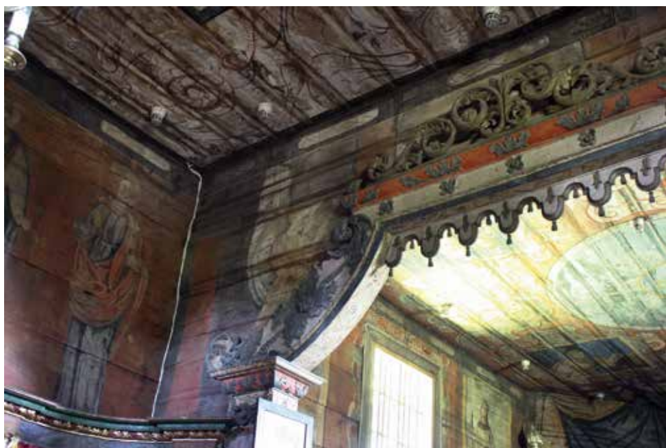
Nawa od strony północnej. Fragmenty ścian tęczowej z rzeźbiarsko dekorowanym łukiem tęczowym oraz północnej z przedstawieniem św. Jana Ewangelisty. Widoczne zaplamienia wokół płóciennych pasów. Fot. M. Pilszek
