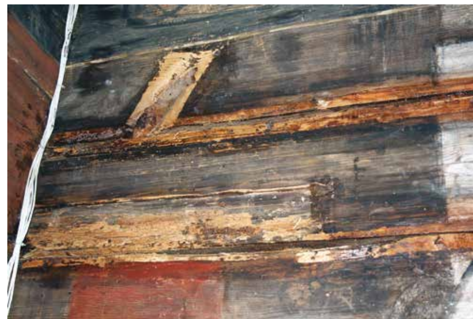
Nawa, ściana tęczowa od strony północnej. Fragment po odklejeniu pasów z lat 80. XX wieku. Widoczne zaplamienia całej powierzchni oraz zniszczenia drewnianego podłoża. Fot. M. Pilszek
