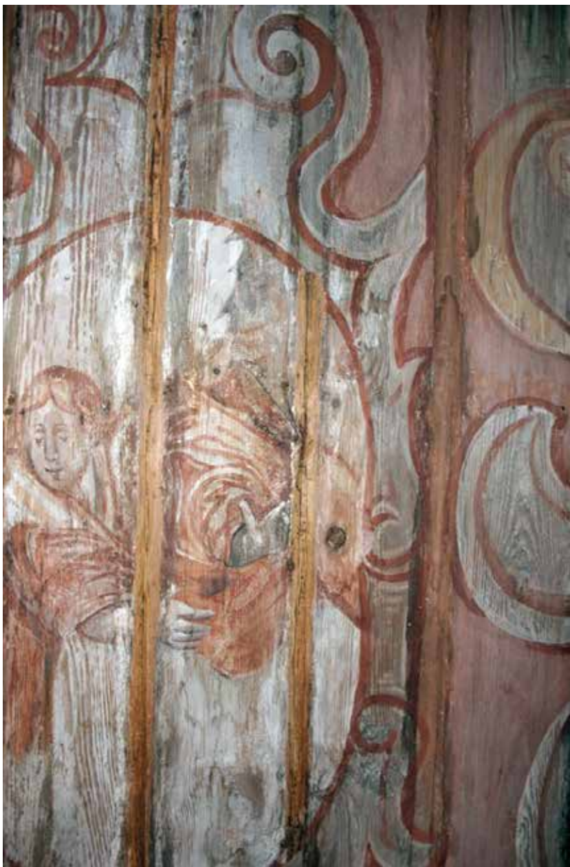
Przedstawienie anioła w pomarańczowej szacie na stropie prezbiterium kaplicy. Stan w trakcie konserwacji, po usunięciu pasów płóciennych, kleju stolarskiego, zaplamień z poliocetanu winylu, brudu, przemałowań oraz kitów trocinowych z lat 80. XX wieku. Fot. P. Taranek
