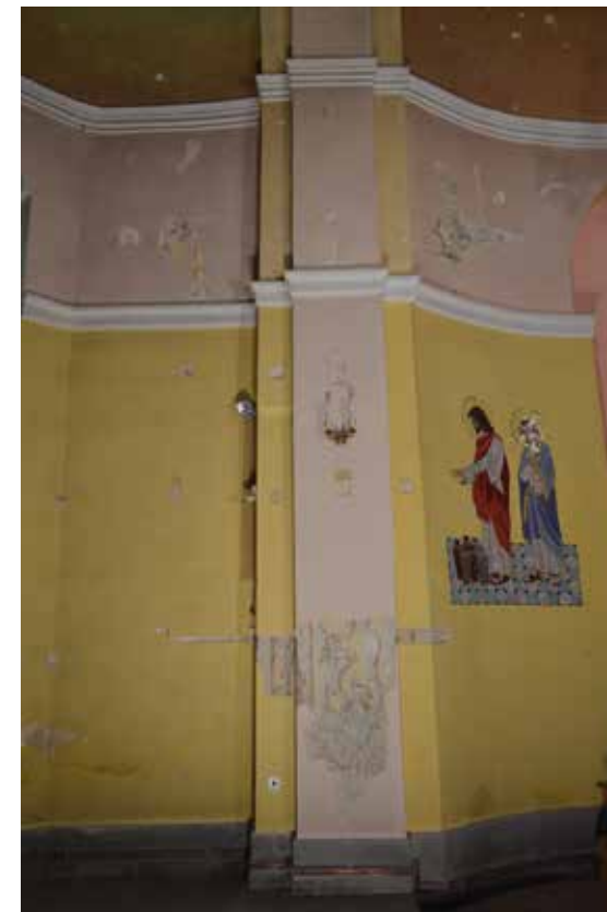
Kaplica pw. św. Antoniego, widoczna odkrywka malowidła z 1765 r. oraz sondy stratygraficzne, ściana wschodnia.
