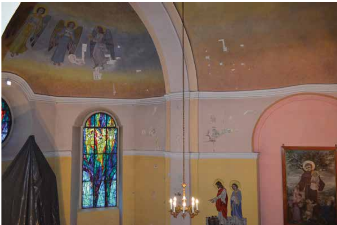
Kaplica pw. św. Antoniego. widoczne odkrywki malowidła z 1765 r. oraz sondy stratygraficzne.
