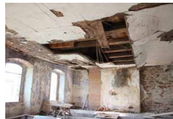
Wnętrze dawnej biblioteki bez okien, ze zdewastowanym stropem i obwisłą podświetlką sprawiało wrażenie katastrofy budowlanej.
