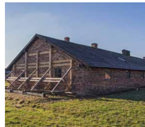
Podparta zewnętrzną konstrukcją zabezpieczającą elewacja jednego z baraków na terenie dawnego obozu Auschwitz-Birkenau.
